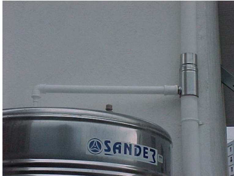
Figura 3- Reservatório de aço inox apoiado, observando o filtro metálico
