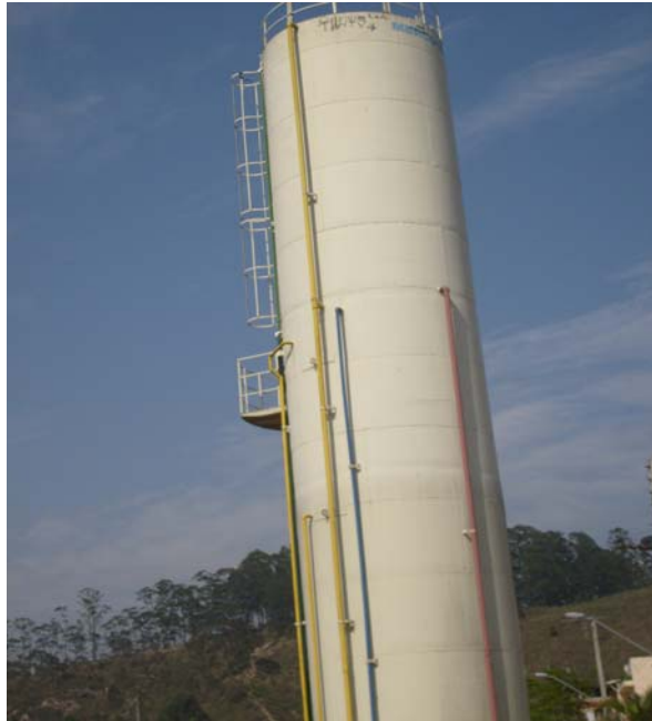
Figura 2.5 Reservatório elevado de estrutura metálica da CMEI Érico Veríssimo (Jardim Fortaleza), Guarulhos – SP
