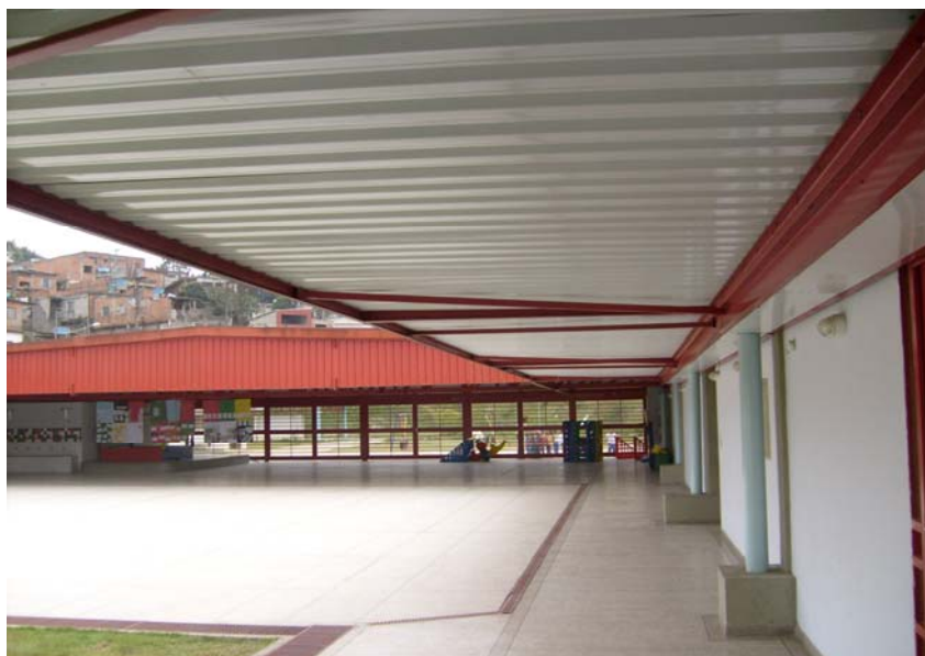
Figura 2.3 Vista do telhado metálico, tubos de PVC verticais de águas pluviais utilizados na construção da CMEI Elis Regina – (Vila Dinamarca), Guarulhos - SP
