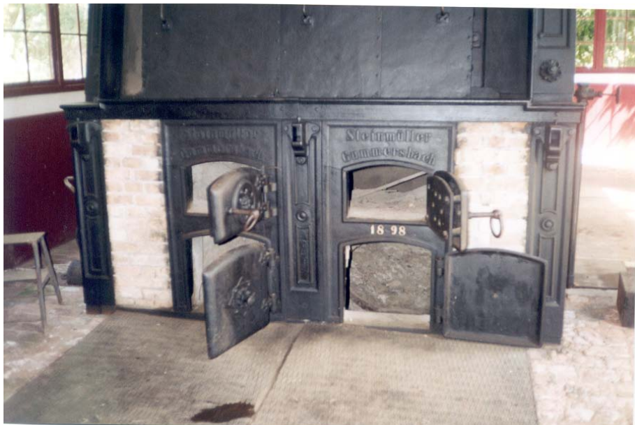
Foto tirado pelo engenheiro Plínio Tomaz em 2002 da Caldeiras alemãs fabricadas em 1898.
