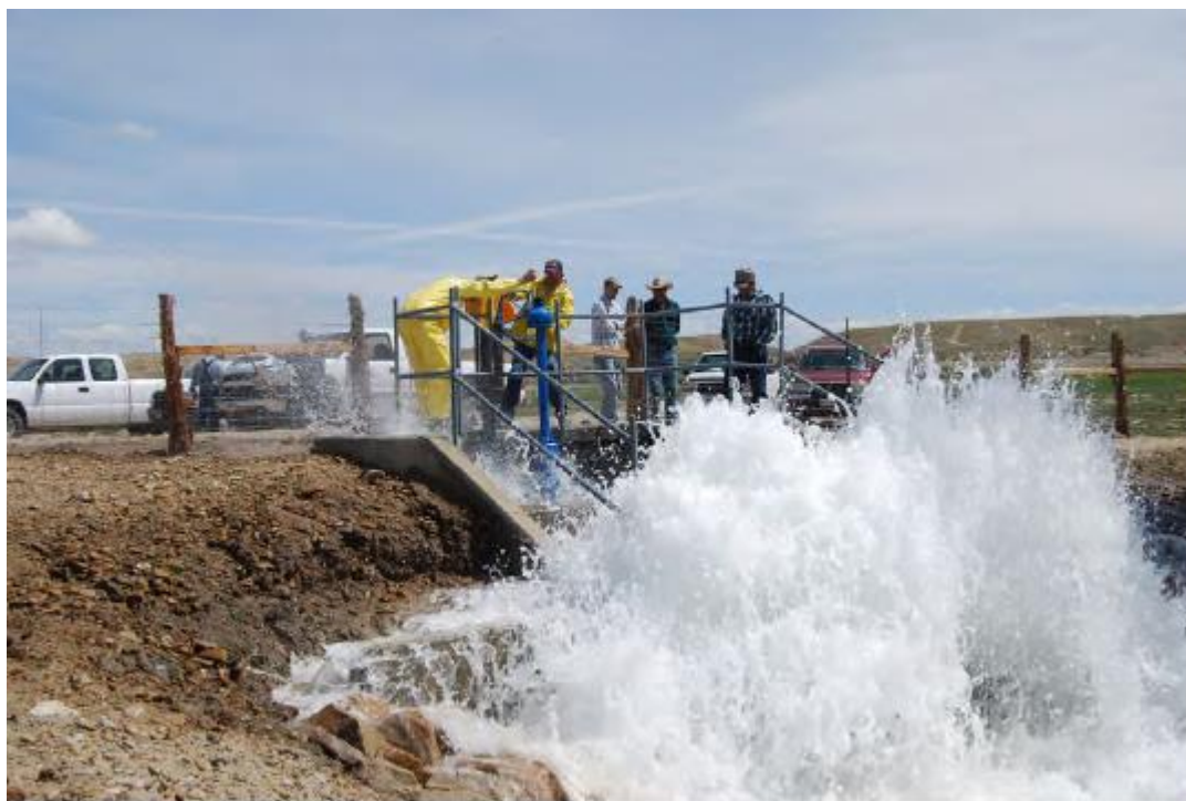
Figura 5- Dissipador de Impacto Tipo VI mal dimensionado. Ficou muito curto o espaço entre a saída da água e o local de impacto. Fema, 2010.
