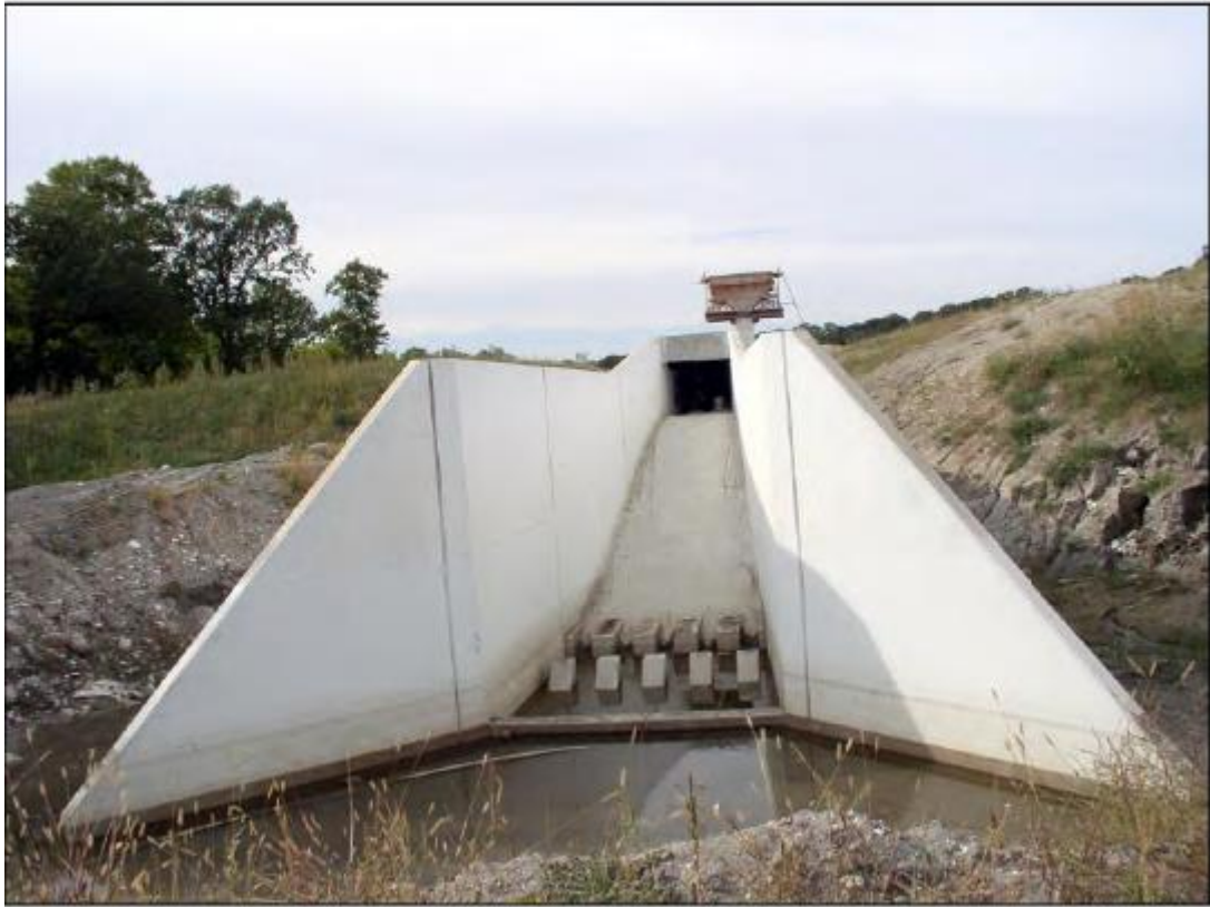
Figura 1- Dissipador SAF. Fonte: Fema, 2010.
