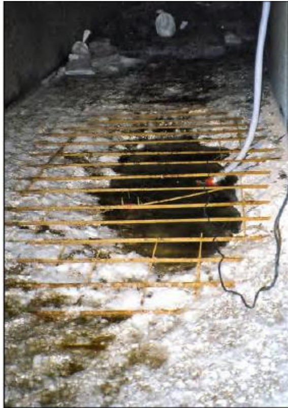
Figura 2- Abrasão. Fonte: Fema, 2010
