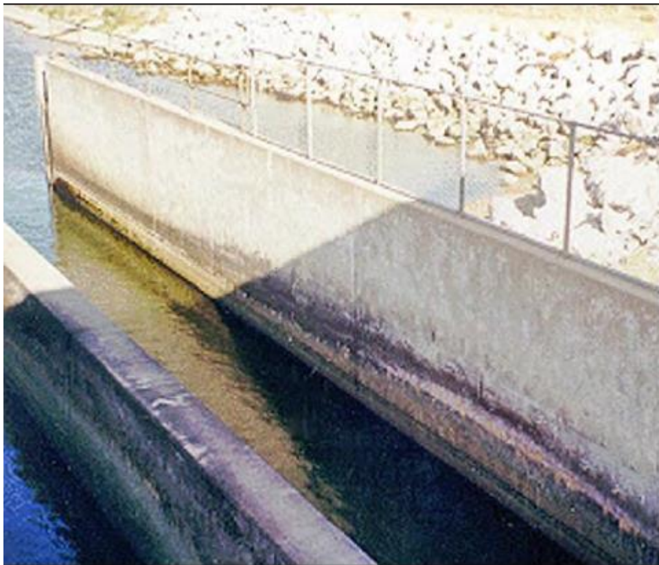
Figura 4-Abrasão. Fonte: Fema, 2010
