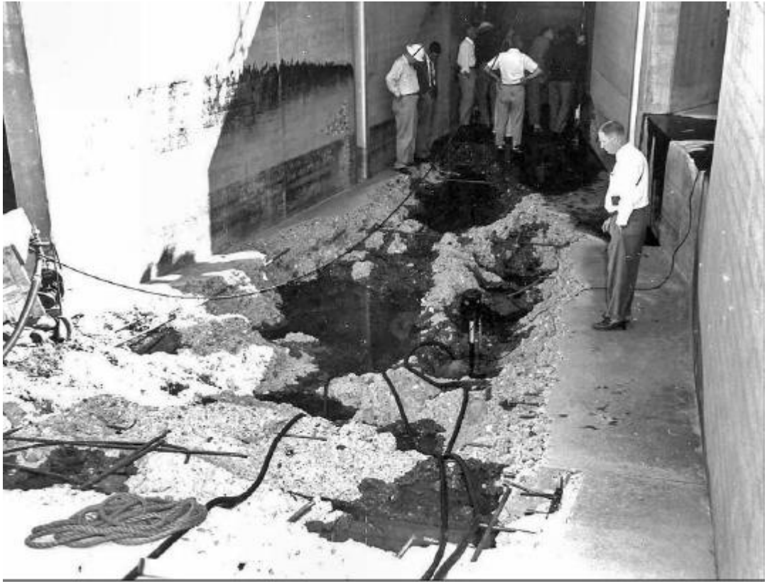
Figura 1- Problemas causados pela cavitação. Fonte: Fema, 2010
