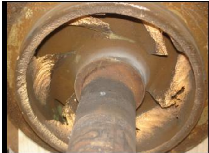
Figura 91.3 Cavitação em bomba no ano 2007
