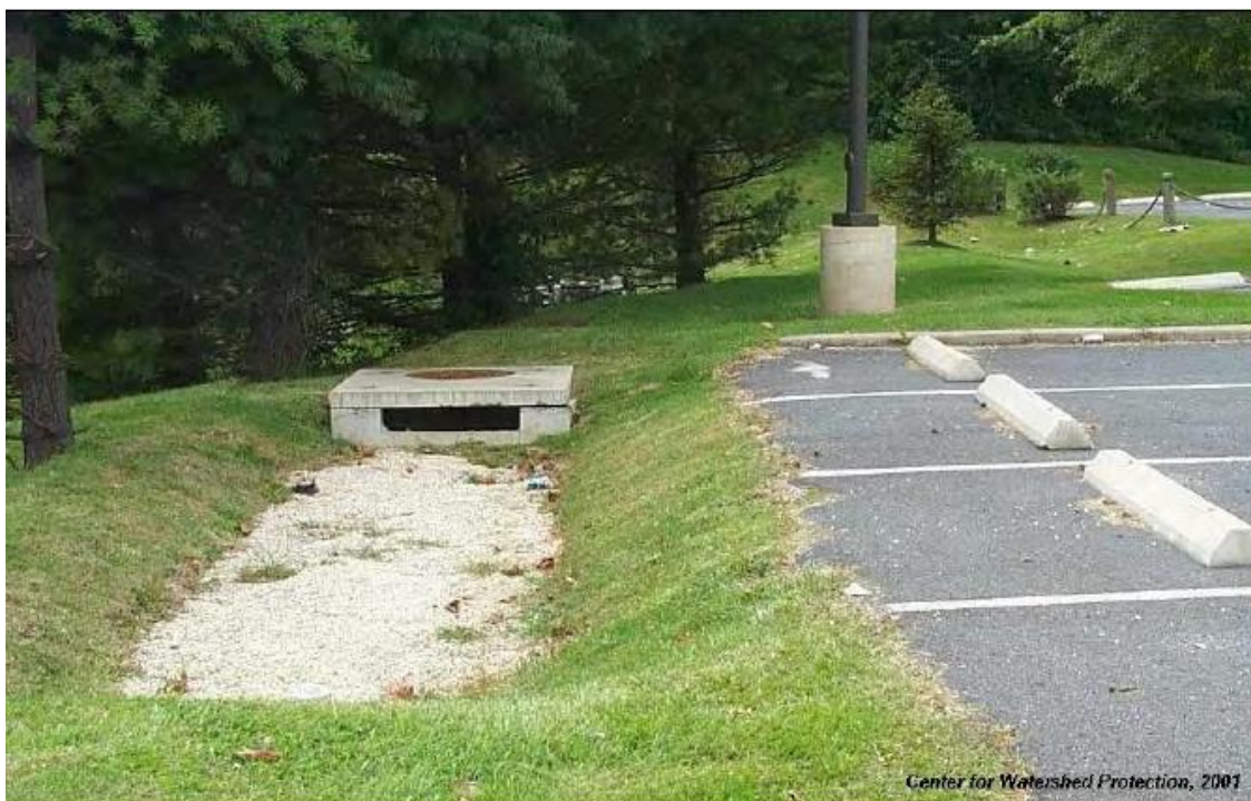
Figura 14.1 - Trincheira de infiltração
