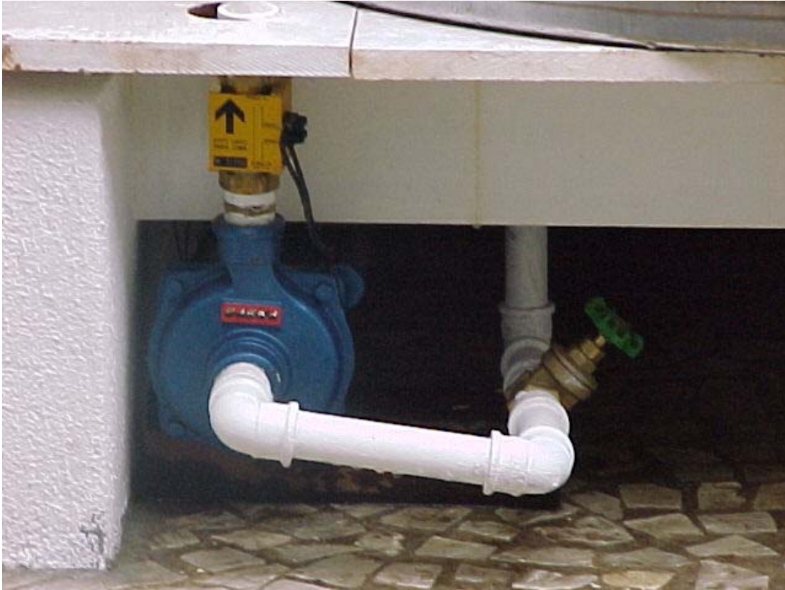
Figura 53.6- Motor usado para bombeamento da água de chuva
