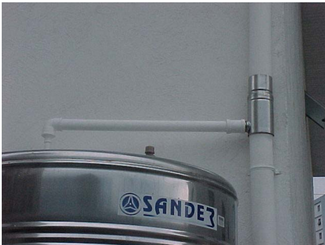
Figura 53.5- Reservatório de aço inox da fabricação pela firma Sander mostrando o dispositivo de autolimpeza denominado “filtro” que está no tubo branco vertical e a tubulação de água a esquerda que entra no reservatório.
