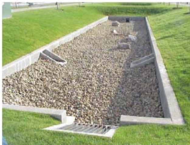
Figura 57.5 - Filtro de areia de superfície.
