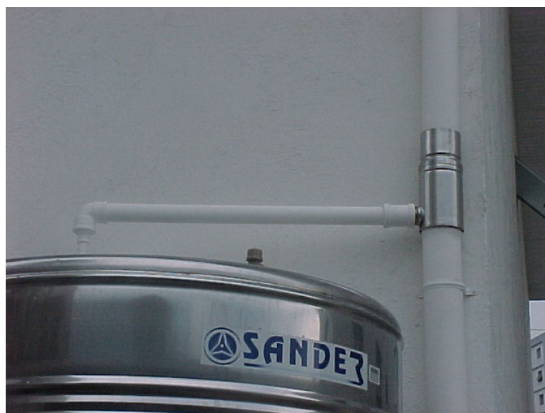
Figura 3.3- Reservatório de aço inox apoiado, observando o filtro metálico
