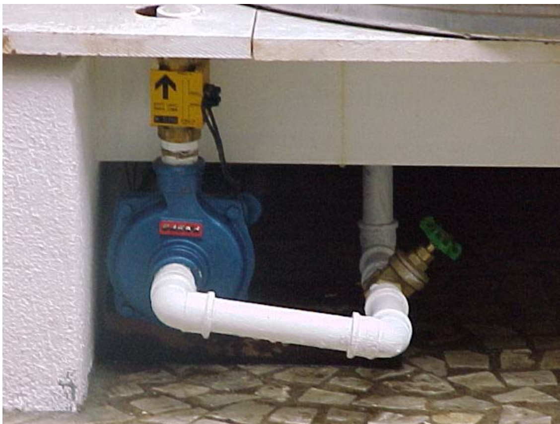
Figura 8.4- Motor usado para bombeamento da água de chuva
