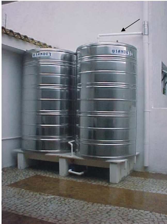
Figura 8.2 - Dois reservatórios de aço inox com 2.000 litros cada. Observar o filtro (seta). http://www.acesita.com.br/download/ind_caso3.pdf
