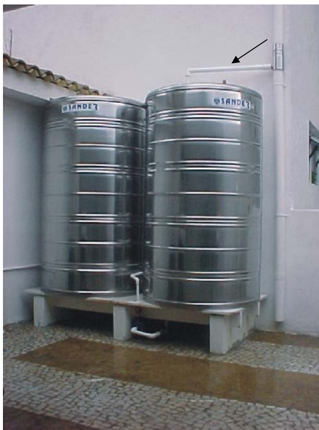
Figura 8.2 - Dois reservatórios de aço inox com 2.000 litros cada. Observar o filtro (seta). http://www.acesita.com.br/download/ind_caso3.pdf
