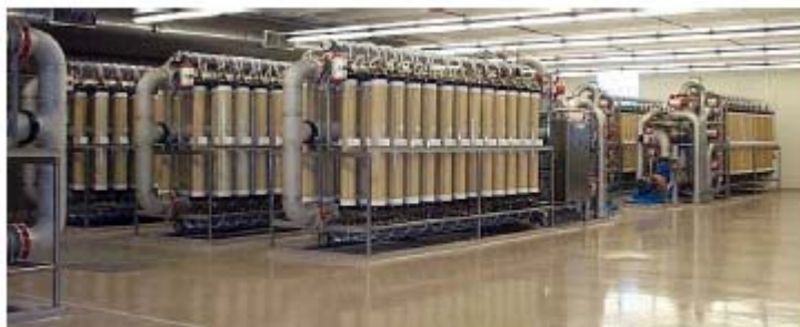
Figura 17.5- Exemplo de aplicação em grande escala de osmose reversa
